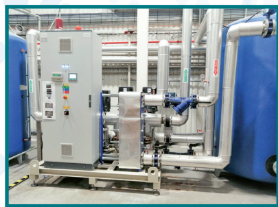
Centrale completa per importante gruppo Farmaceutico estero.
