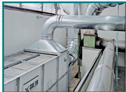
Impianto di recupero calore da fumi installato presso una società di Arzignano (VI) che lavora le pelli.
